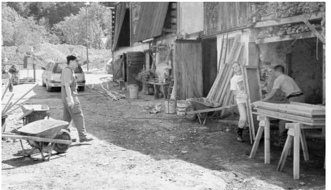
Aufräumarbeiten. In enger Zusammenarbeit mit Kantons- und Gemeindebehörden führte der Basler Zivilschutz Aufräumarbeiten auf mehreren Baustellen durch.
