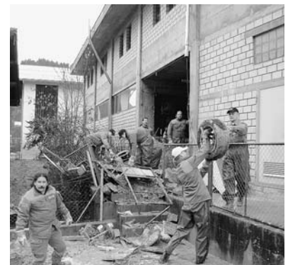
Zivilschützer als Allrounder in Sachen Hilfe. Auch Keller und Werkstätten mussten vom Schlamm befreit werden.
